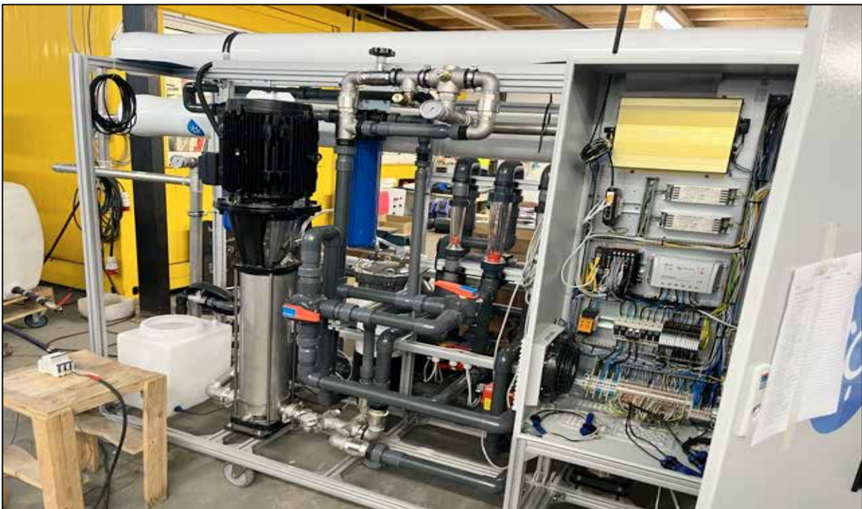
Bild: Ausstattung der Boreal Light 2000l /h Anlage mit Reinigungsstufen und Control System
